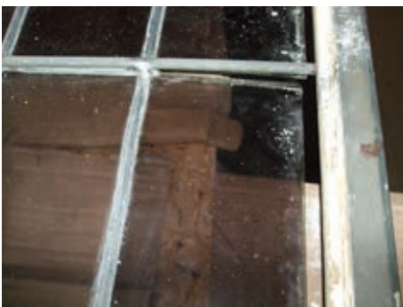
MANGE AV VINDUENE var i svært dårlig forfatning.
